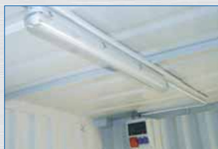
corpuri de iluminat
